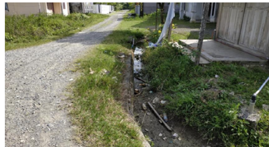
Gambar 1 Sedimentasi Pada Saluran Beton Sumber : Hasil survey 2019
