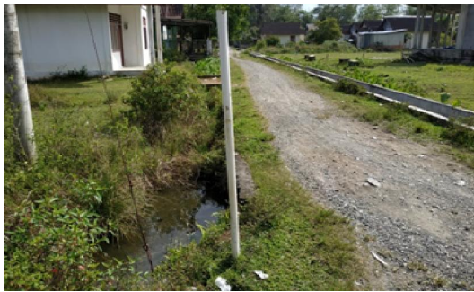
Gambar 3 Sedimentasi Pada Saluran Beton Sumber : Hasil survey 2019
