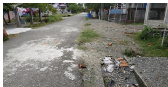
Gambar 2 Sedimentasi Pada Saluran Beton Sumber : Hasil survey 2019
