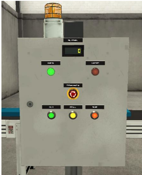
Gambar 5. Kondisi Lamp ON
