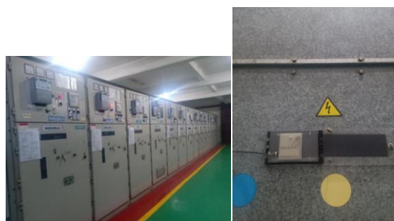
Gambar 26. Implementasi Alat pada Kubikel 20 kV
