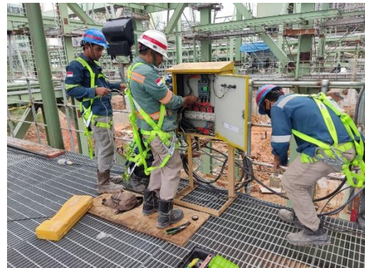
Gambar 15. Pemeriksaan dan Pengujian Panel SDP oleh Supervisor Electrical
