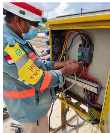
Gambar 16. Pemeriksaan dan Pengujian Panel SDP oleh Supervisor Electrical
